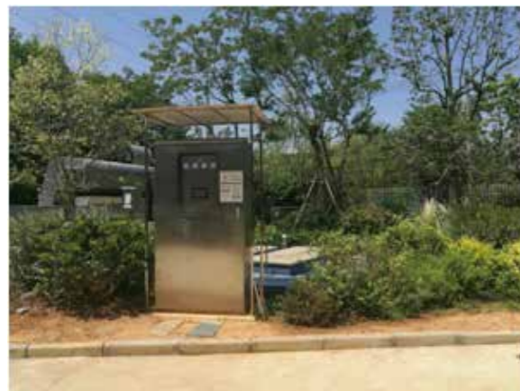
安徽国社环保工业园区排水 泵站日排水量：50000m 3 /D 泵站规格：DN3800*8600
