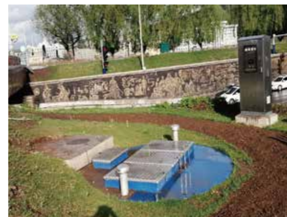
通化红旗桥泵站
