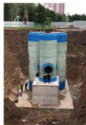
平庄城区排水系统改造项目排水泵站
