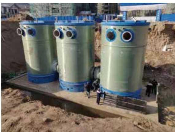
河北四季小镇雨水泵站
